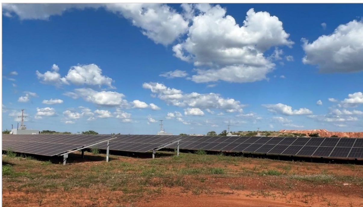
Figura 46. Painéis solares para produção de energia
