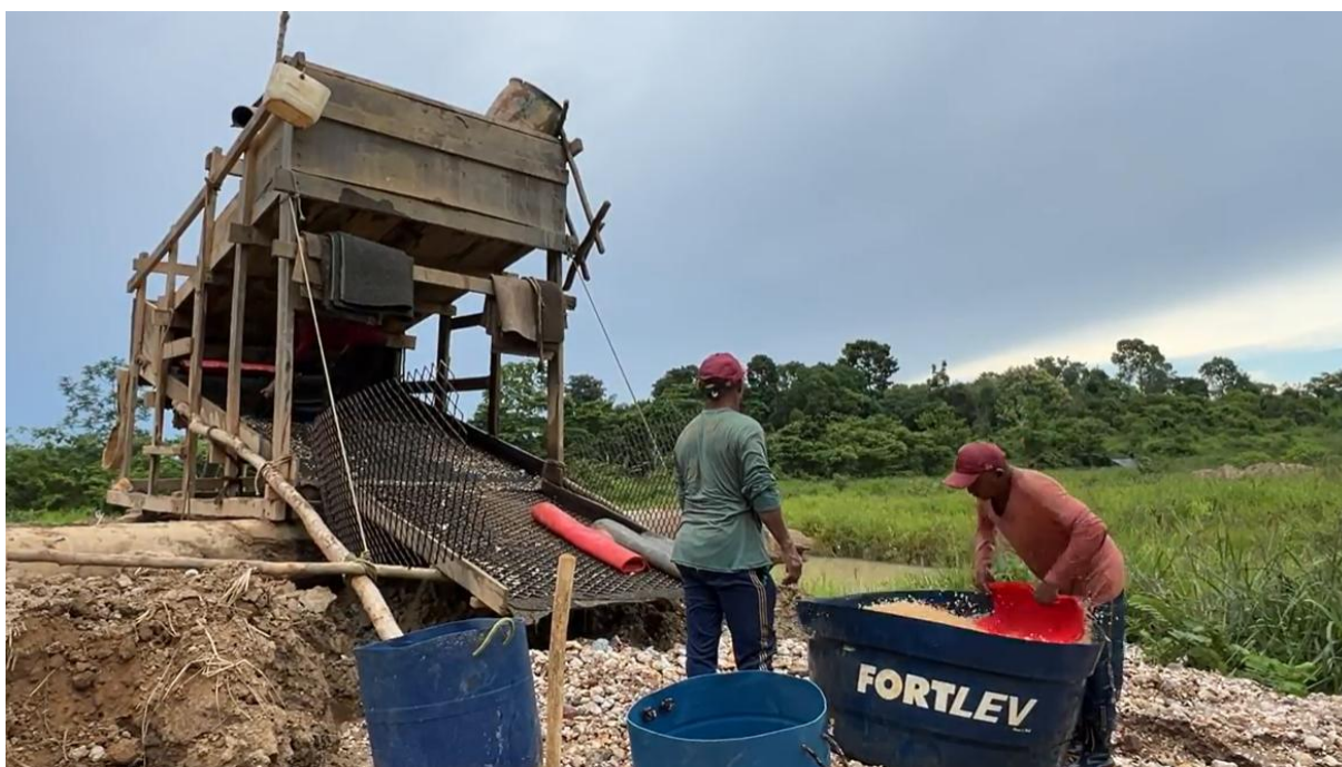
Figura 67. Concentração do material da calha concentradora
